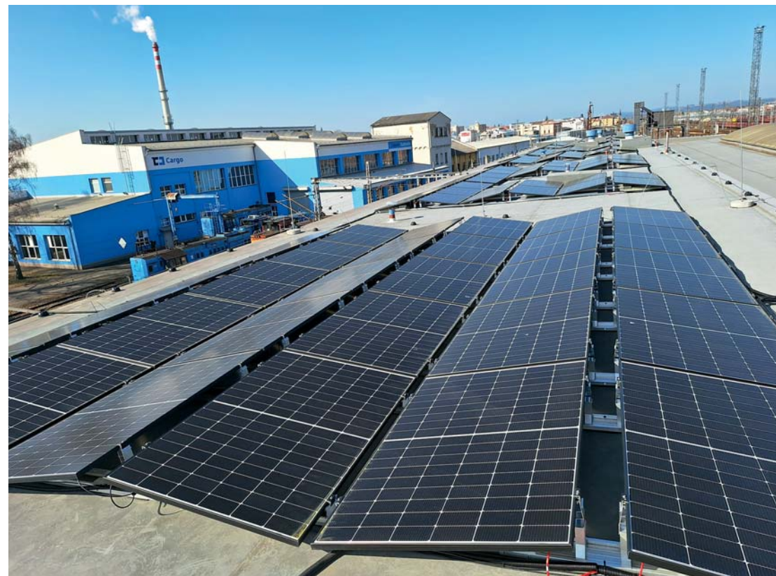
Fotovoltaické panely v SOKV České Budějovice FOTO: STANISLAV BILEC
