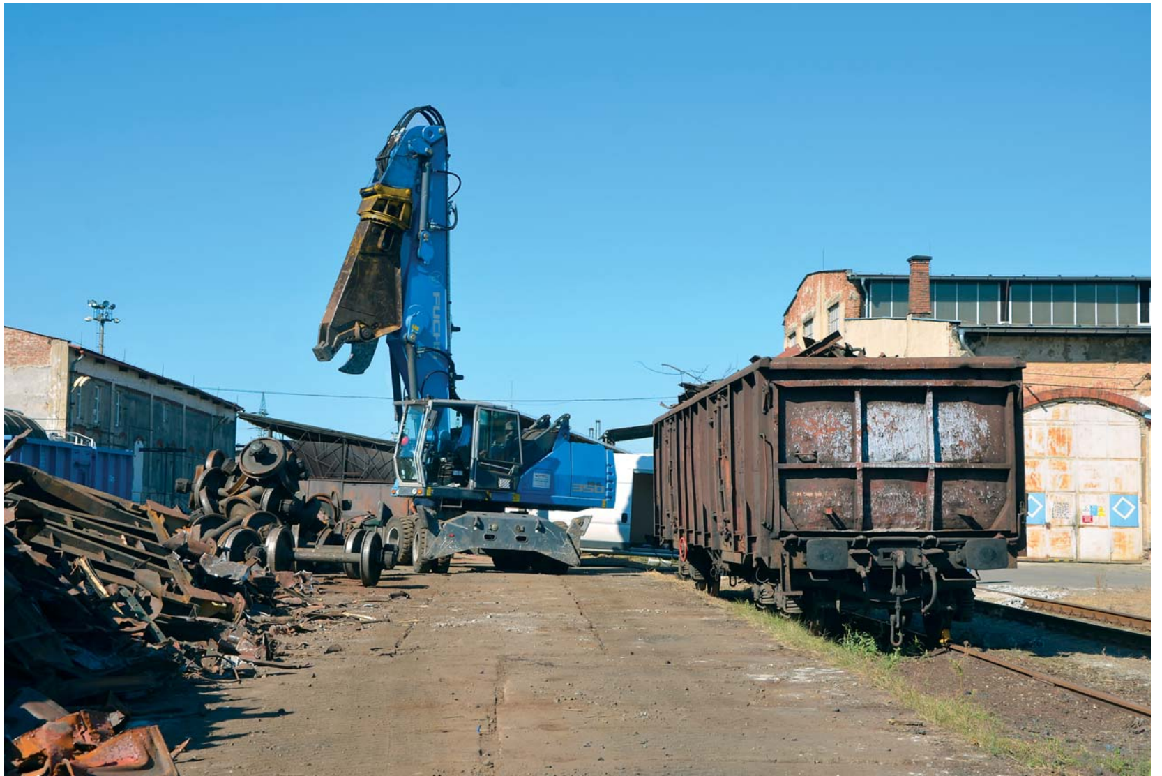
V letošním roce bude společnost ČD Cargo pokračovat v likvidaci nepotřebných nákladních vozů a také lokomotiv. Jedná se o technicky i legislativně poměrně náročný proces, na jehož konci není jen šrot odprodáný do hutí, ale i vyzískaný materiál, který upotřebíme např. při opravách dalších vozů. Foto: Michal Roh
