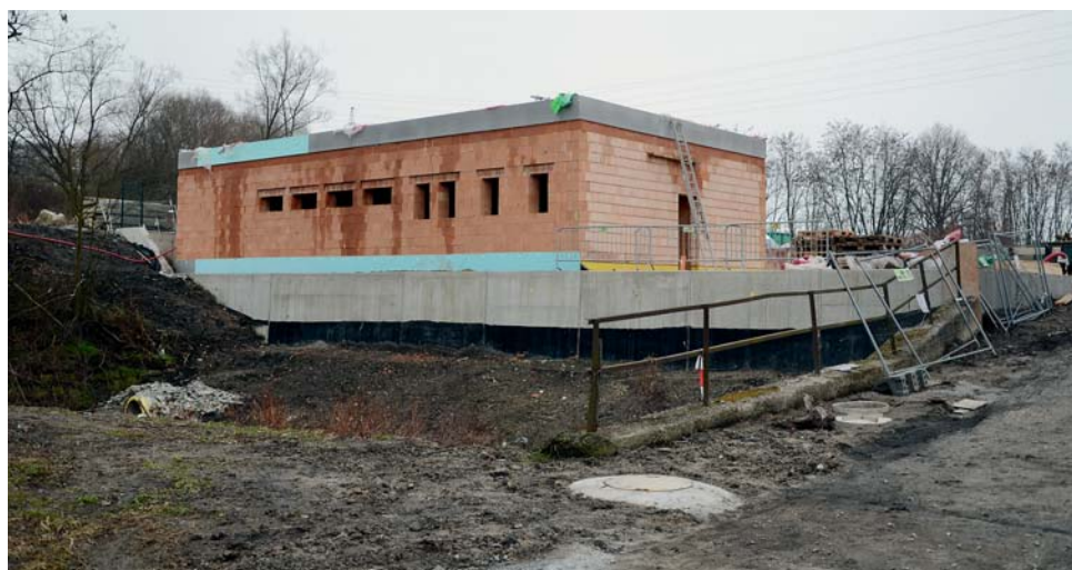
Rozestavěná budova zázemí pro zaměstnance nové opravy nákladních vozů v Českých Budějovicích
