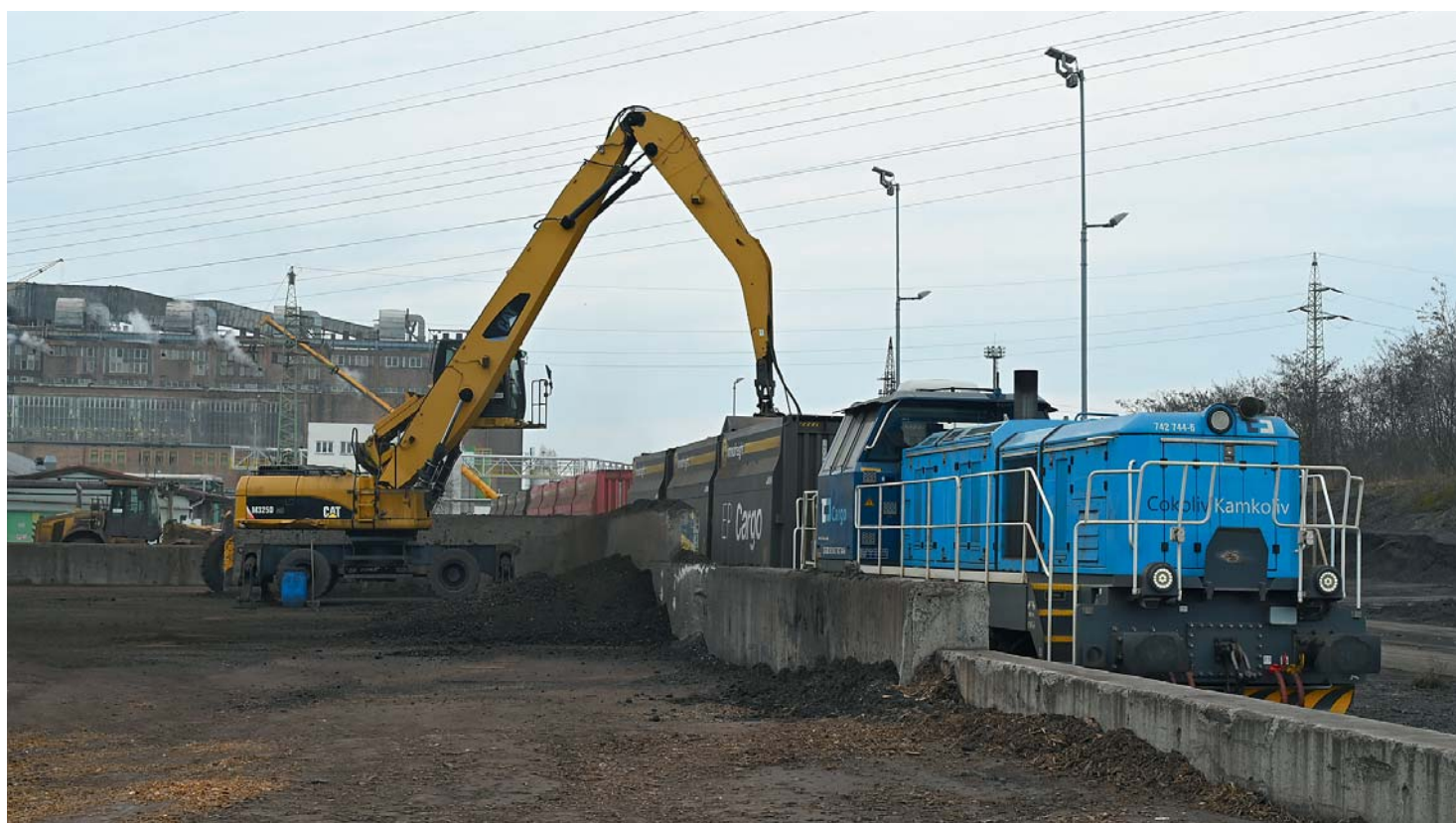
Der Bahnanschluss der Heizungsanlage besteht aus nur einem Anschlussgleis, auf dem die Kohle entladen wird.
