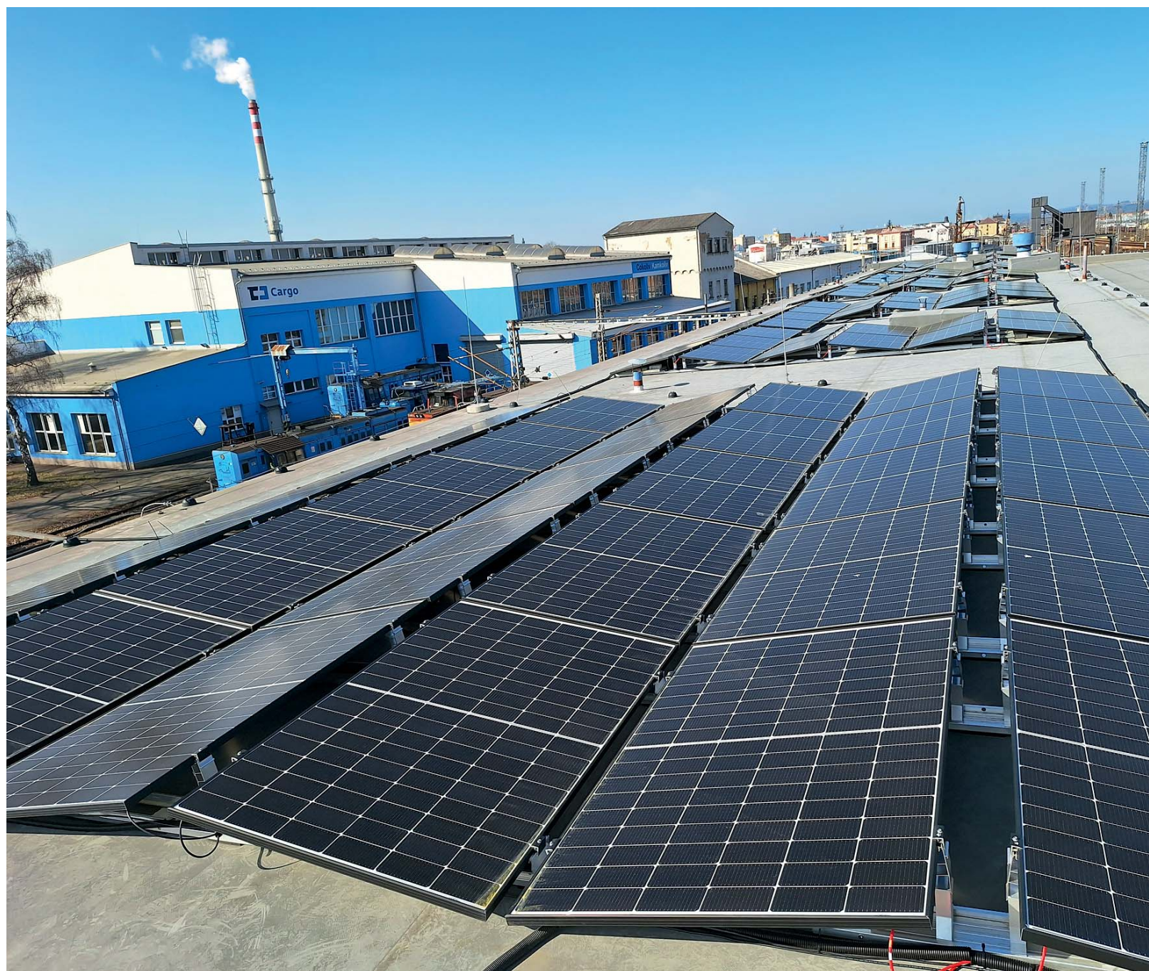
Photovoltaikmodule bei SOKV České Budějovice FOTO: STANISLAV BILEC
